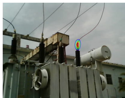
变电设备局部放电
