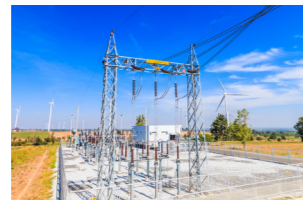
变电设备局部放电
