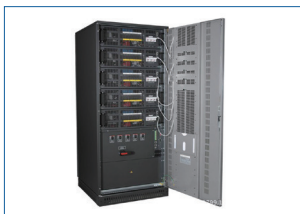
机柜集成安装
